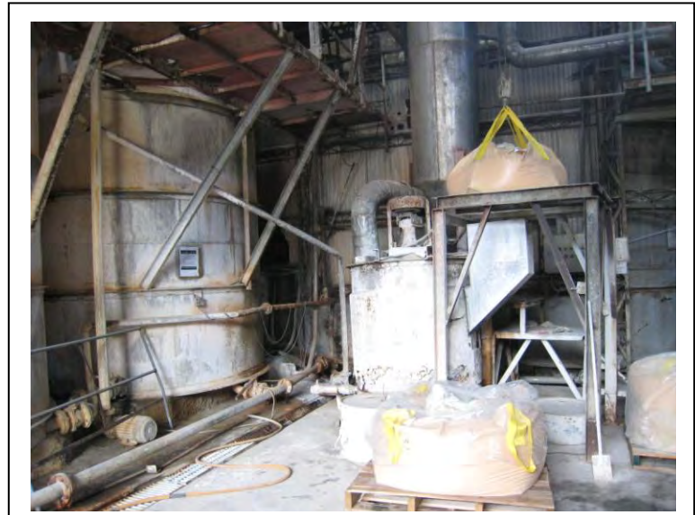
右圖為製造三鹽基性硫酸鉛廠房中的機具。圖片右方為傾倒黃丹的攪拌槽，左方為不銹鋼材質的反應爐。
