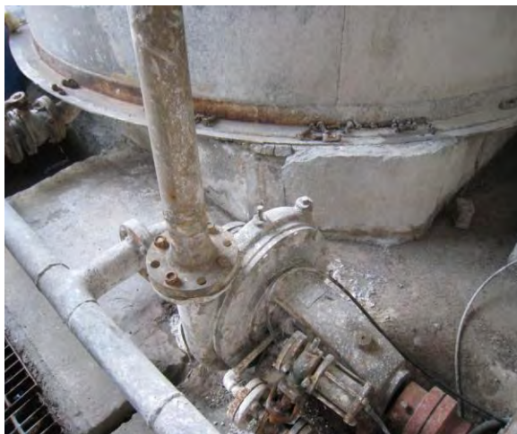
照片 3：在三鹽基性硫酸鉛製造廠房，機具螺絲缺漏。
