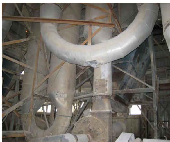
照片 5：在乾燥三鹽基性硫酸鉛的管路中，清潔孔蓋沒有扣好。
